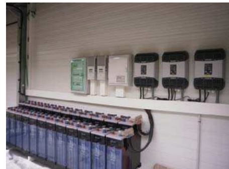
Babes, erreguladore, inbertsore eta bateria-sailaren koadroa
