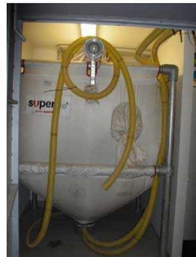
Pelleten silo malgua
