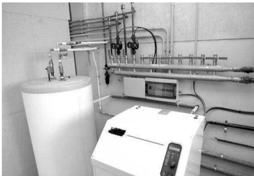
Geotermiako bero ponpa, Araiako kiroldegia
