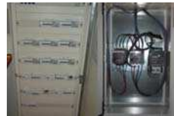
Kaxa eta babes elektrikoak
