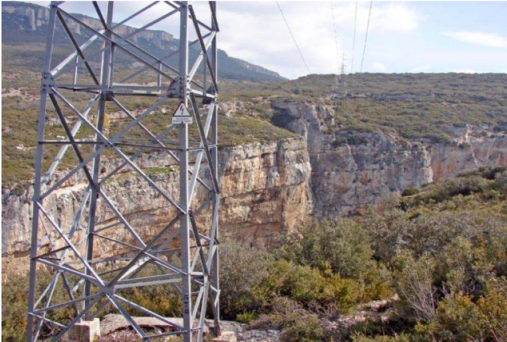
Paso de la línea de alta tensión a 220 kV Orkoien - Sabiñánigo por la Foz de Lumbier. Fuente: www.mendikat.net .
